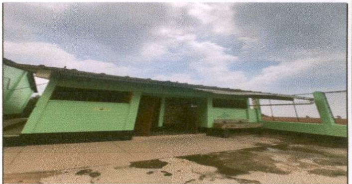
Foto 6: Estado actual de canales y bajadas de agua
