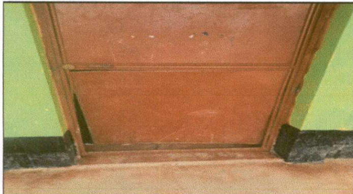
Foto 3: mal estado de las puertas
