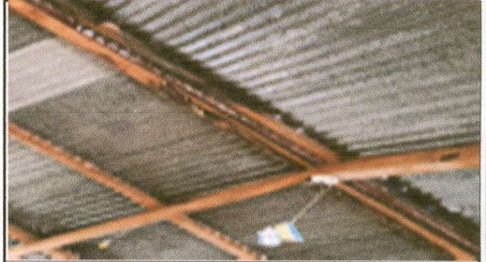
Foto 2: Estado actual de las vigas de madera
