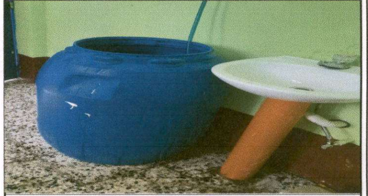
Foto 8: Estado actual de los recipientes para guardar agua para la limpieza de los baños
